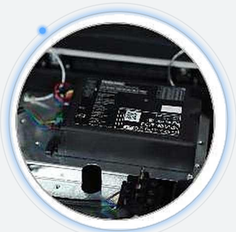
驱动电源仓 — 可拆卸接线板
