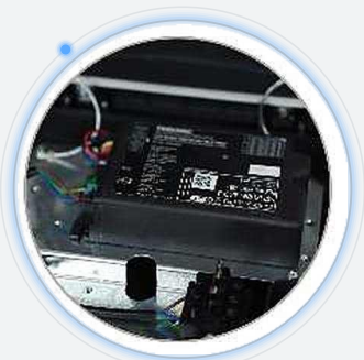
Compartimento del driver — placa de cableado extraíble
